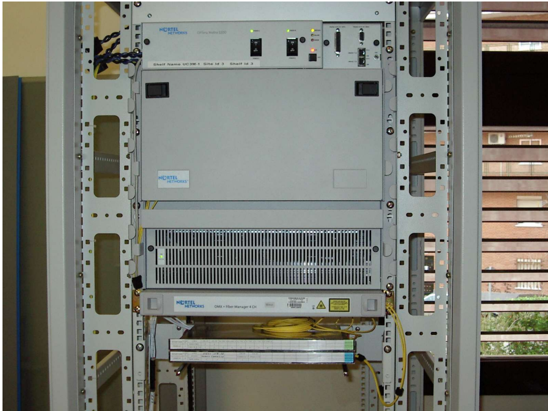
Infraestructura de comunicaciones de altas prestaciones del Departamento de Ingeniería Telemática
