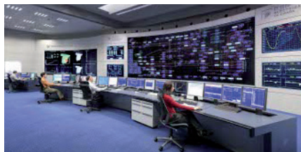
Imagen del Centro de Control Eléctrico (REE)
