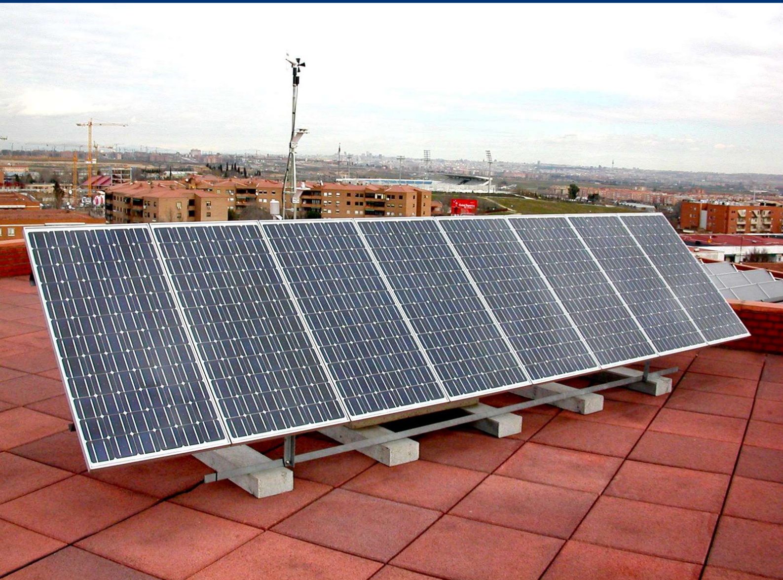
Instalación fotovoltaica experimental del Grupo de Control de Potencia
